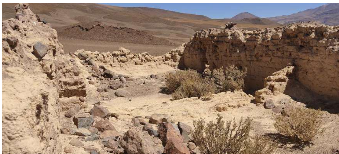
Figura 12. Vista interior de los recintos A (al fondo) y B (en primer plano) de la “Ruina de una antigua posada”. ( Nota. Nótese los muros de adobe colapsados, especialmente el que separó los recintos A y B).
