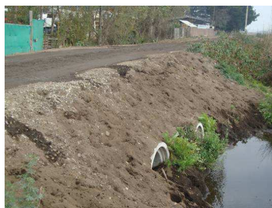
Rellenos del humedal y tuberías de descargas al cuerpo de agua.
