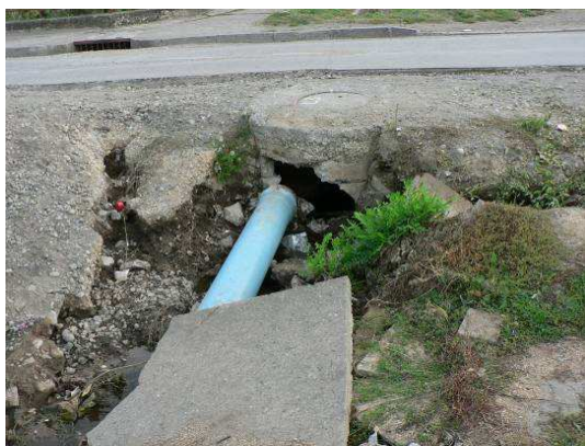
Descargas de aguas pluviales hacia la laguna, las cueles se encuentran destruidas desde el terremoto de febrero de 2010, el cual se puede mezclar co aguas servidas.
