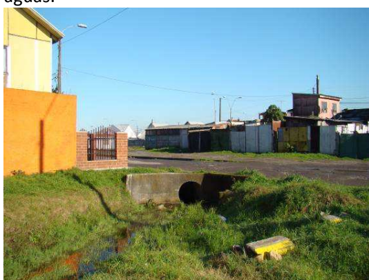
Tubería de descarga de aguas lluvias que desemboca al humedal.
