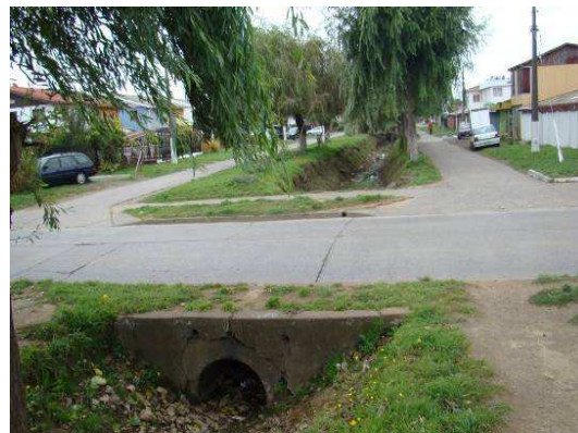
Tubería para drenar el agua hacia el humedal Villa Dinahue.
